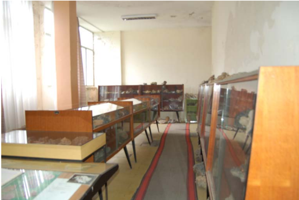
Photo 4 - Vue d'une autre salle du musée ; on aperçoit les dégradations au plafond et au mur de droite
